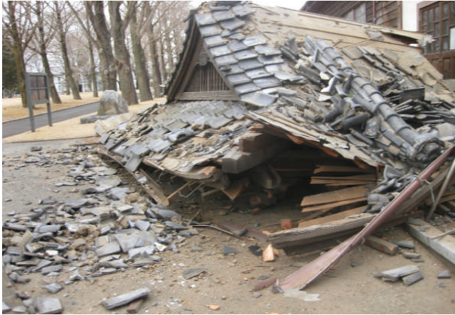
崩落した玄関廂（旧水戸農業高等学校本館）
