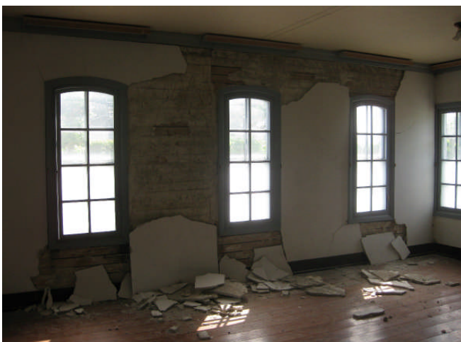
内壁の剥落（旧水海道小学校本館）
